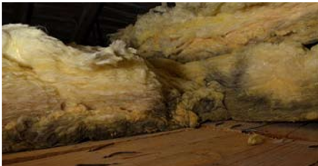
Développement de moisissures
