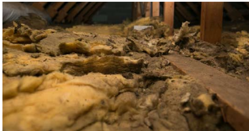
Alourdissement puis tassement
